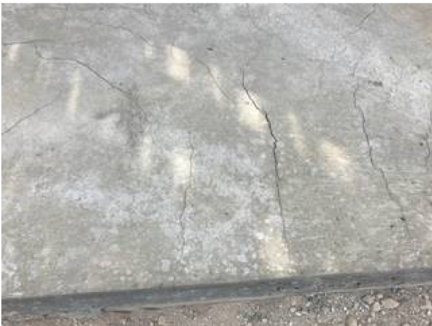
Imagen 1.1 Representación de agrietamiento por contracción plástica.
